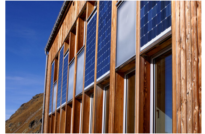
PV-Paneele und Transparente Wärmedämmung
