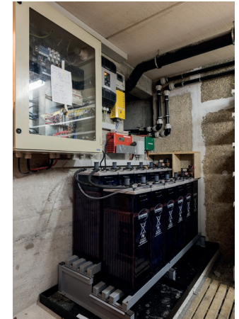
Local batteries © davidschweizer.ch
